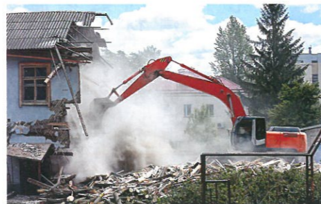
アスベストが出た場合、解体工事の発注者が届け出をしなければならぬので注意が必要だ
